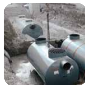
Ocelový odlučovač oleje na skládce kovového odpadu Pamplona (Španělsko)
